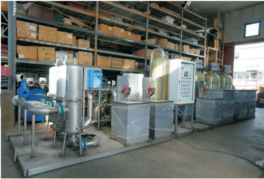
Centralina di comando per impianto automatico di abbinamento dei cromati e dei cianuri.
